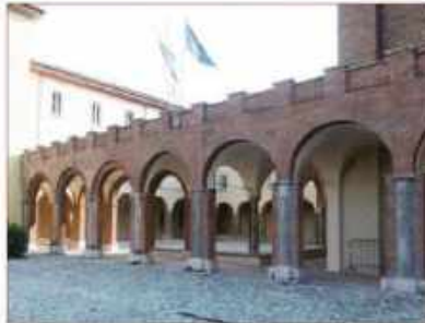
Chiostro ex chiesa del Carmine (muratura in laterizio a vista - intradosso volte intonacato e tinteggiato in giallo chiaro)
